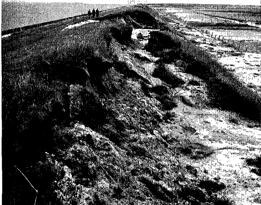
Dijk met aangetast binnenbeloop
